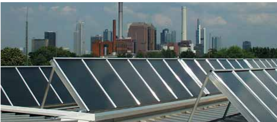
Solaranlage auf dem Friedrichsheim
