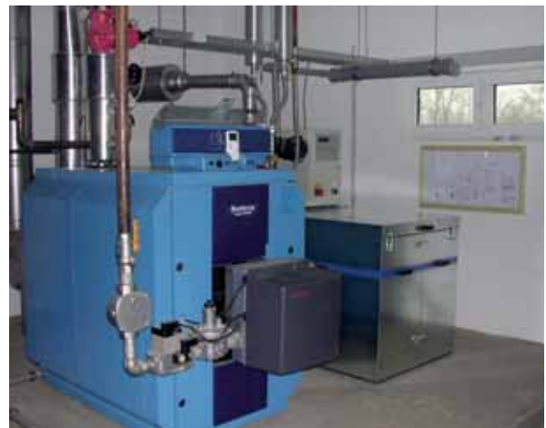
In der Karl-Kirchner-Siedlung steht neben dem Heizkessel das BHKW-Modul.
