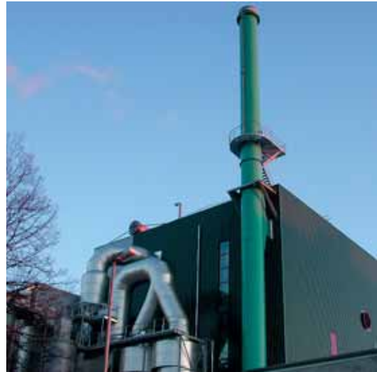
Biomasse Kraftwerk Fechenheim, Abgasreinigung
